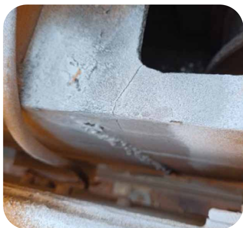
Rys. 3. Pęknięcie konstrukcji czołownicy
