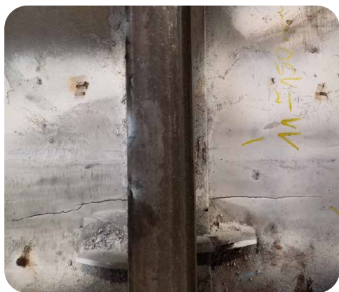
Rys. 2. Pęknięcie górnego pasa dźwigara
