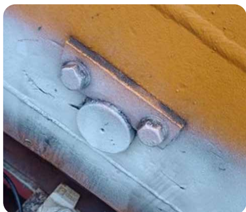
Rys. 4. Pęknięcie konstrukcji czołownicy
