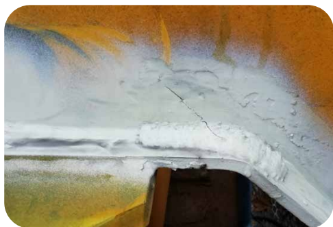
Rys. 1. Pęknięcie konstrukcji dźwigara
