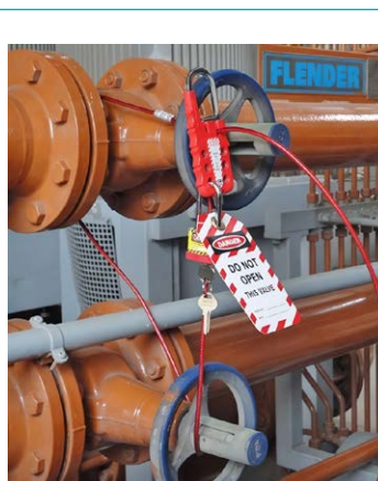
Rys. 4a. System LOTO na zaworze odcinającym [https://www.lockout-safetyproducts.com/product/cable-lockout/ – dostęp: 11.2024]
