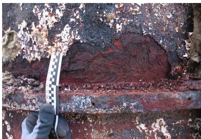
Rys. 2. Obraz lokalnej korozji powstałej na zewnątrz zbiornika ze stali niestopowej wskutek oddziaływania mechanizmu degradacji - korozja pod izolacją (CUI)
