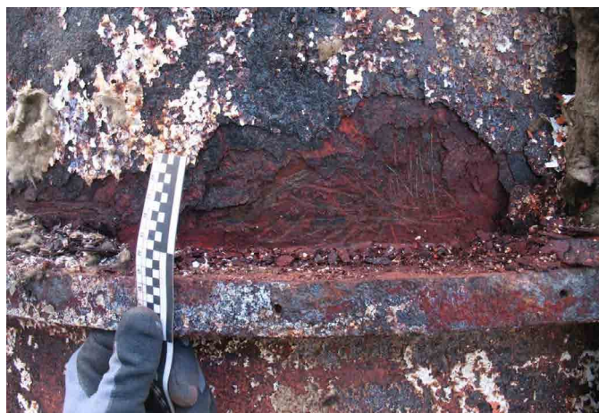
Rys. 2. Obraz lokalnej korozji powstałej na zewnątrz zbiornika ze stali niestopowej w wyniku oddziaływania mechanizmu degradacji - korozji pod izolacją (CUI)
