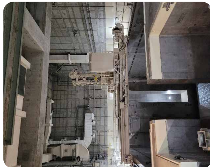
Rys. 1A. Przykładowe urządzenie transportu bliskiego (UTB), stanowiące wyposażenie transportowo-technologiczne do przemieszczania i składowania paliwa jądrowego (wg § 2. 1 pkt. 13 [2])
