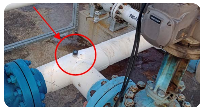
Rys. 6. Czujnik drgań zainstalowany na rurociągu
