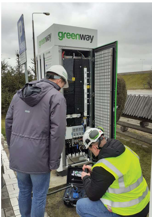
Odbiór stacji ładowania w Nowym Cieszącu (zdj. Jarosław Kozłyk, Departament Techniki UDT)
