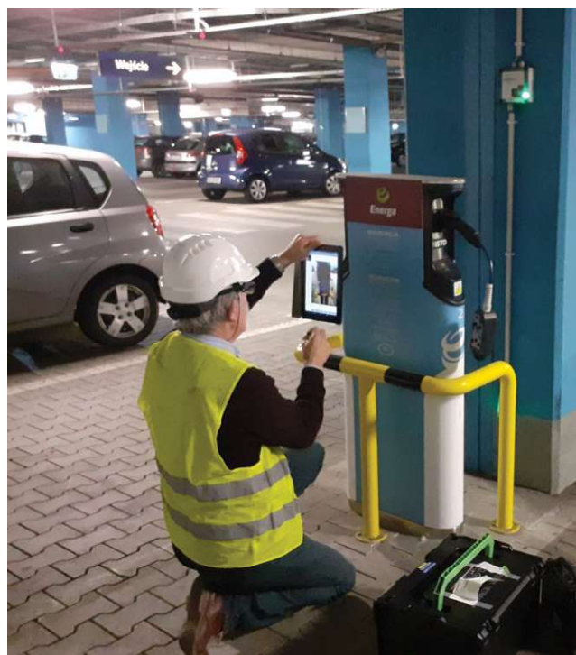
Odbiór stacji ładowania w Ostrowie Wielkopolskim (zdj. Mariusz Wasilewski, Departament Techniki UDT)
