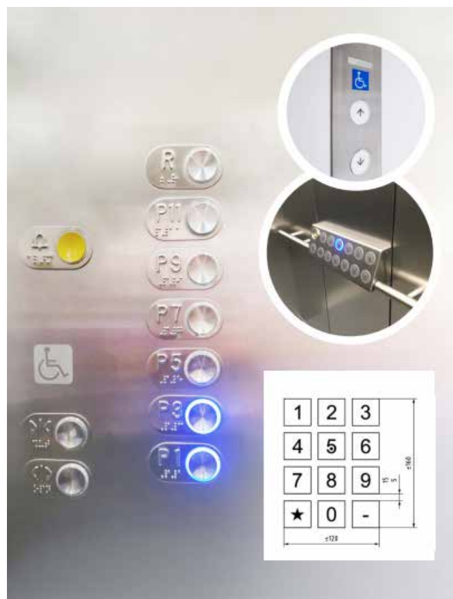
Rys. 11. Przykłady dostosowania urządzeń sterowniczych i sygnalizacyjnych dźwigu
