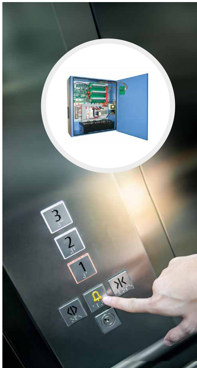
Rys. 5. Wyposażenie dźwigu w łączność alarmową i system automatycznego uwalniania
