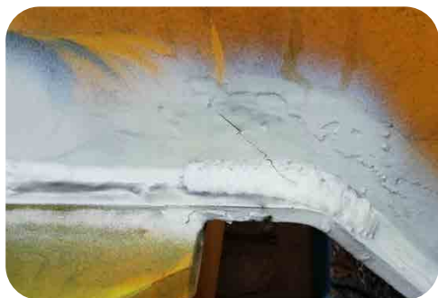
Rys. 1. Pęknięcie konstrukcji dźwigara
