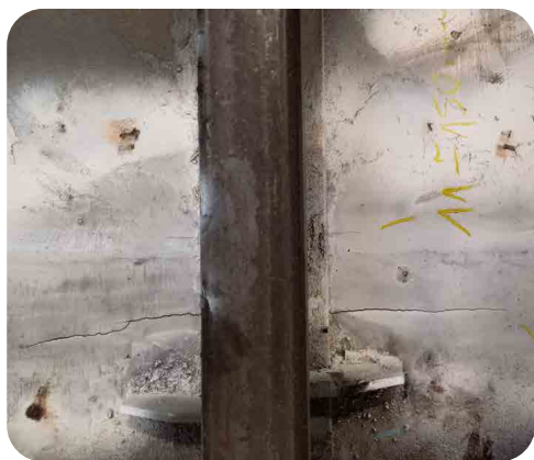
Rys. 2. Pęknięcie górnego pasa dźwigara
