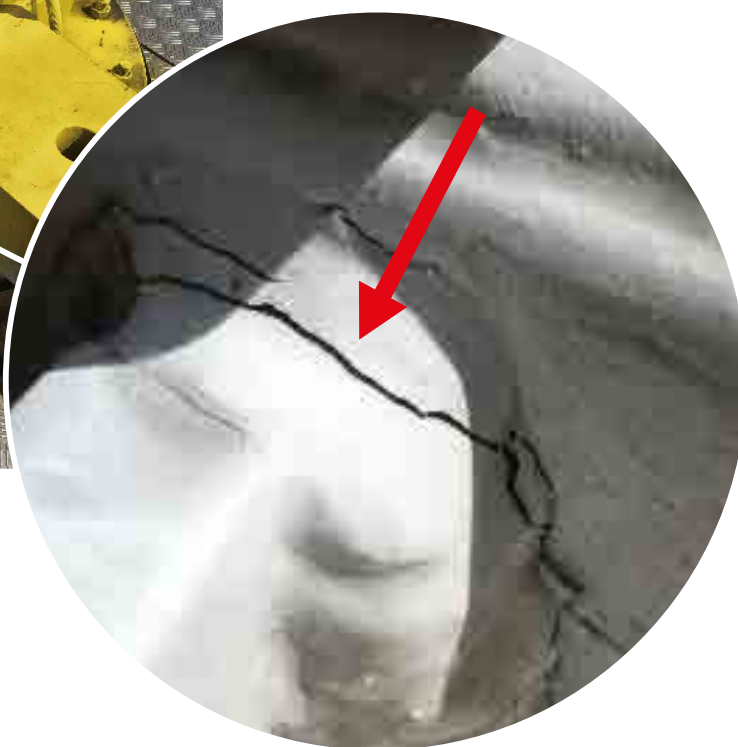
Rys. 7. Wskazanie pęknięcia konstrukcji
