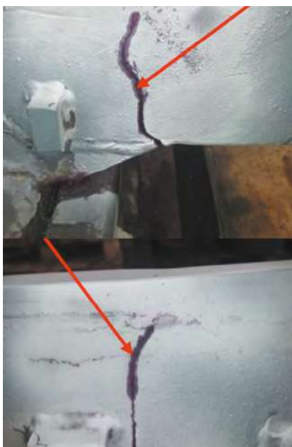
Rysunek 4. Pęknięcia płyty czołowej (karetki) wózka wykryte w trakcie prowadzenia badań NDT
