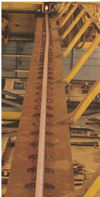
Rys. 12. Deformacja dźwigara suwnicy
