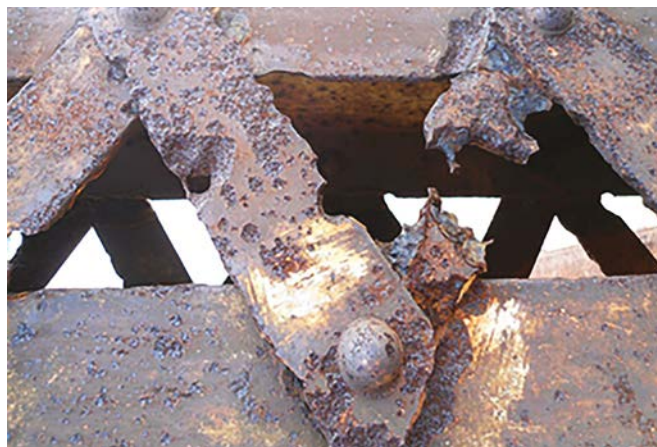
Rys. 10. Ubytki korozyjne konstrukcji
