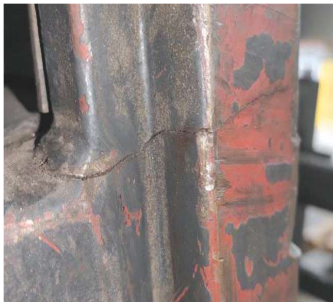
Rysunek 4. Pęknięcie materiału rodzimego masztu wózka jezdniowego podnośnikowego z mechanicznym napędem podnoszenia
