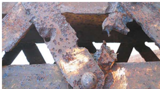
Rysunek 2. Ubytki korozyjne konstrukcji
