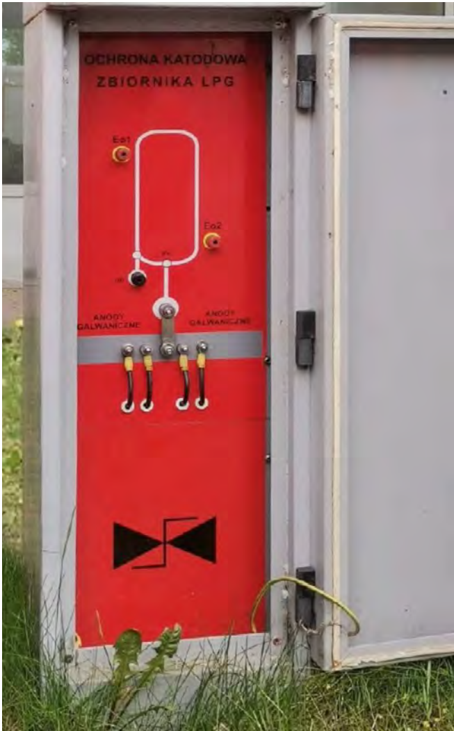
Zdj. 3. Pomiary w stacji anod galwanicznych w instalacji ochrony katodowej zbiornika podziemnego [4]
