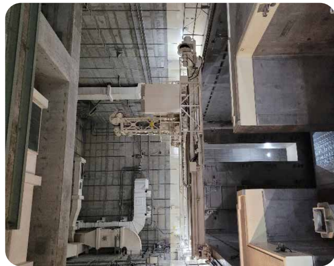
Rys. 1A. Przykładowe urządzenie transportu bliskiego (UTB), stanowiące wyposażenie transportowo-technologiczne do przemieszczania i składowania paliwa jądrowego (wg § 2. 1 pkt. 13 [2])
