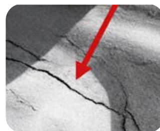
Rys. 7. Wskazanie pęknięcia konstrukcji
