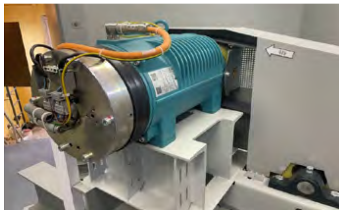
Rys. 1. Zdjęcie maszynowni z wciągarką bezreduktorową
