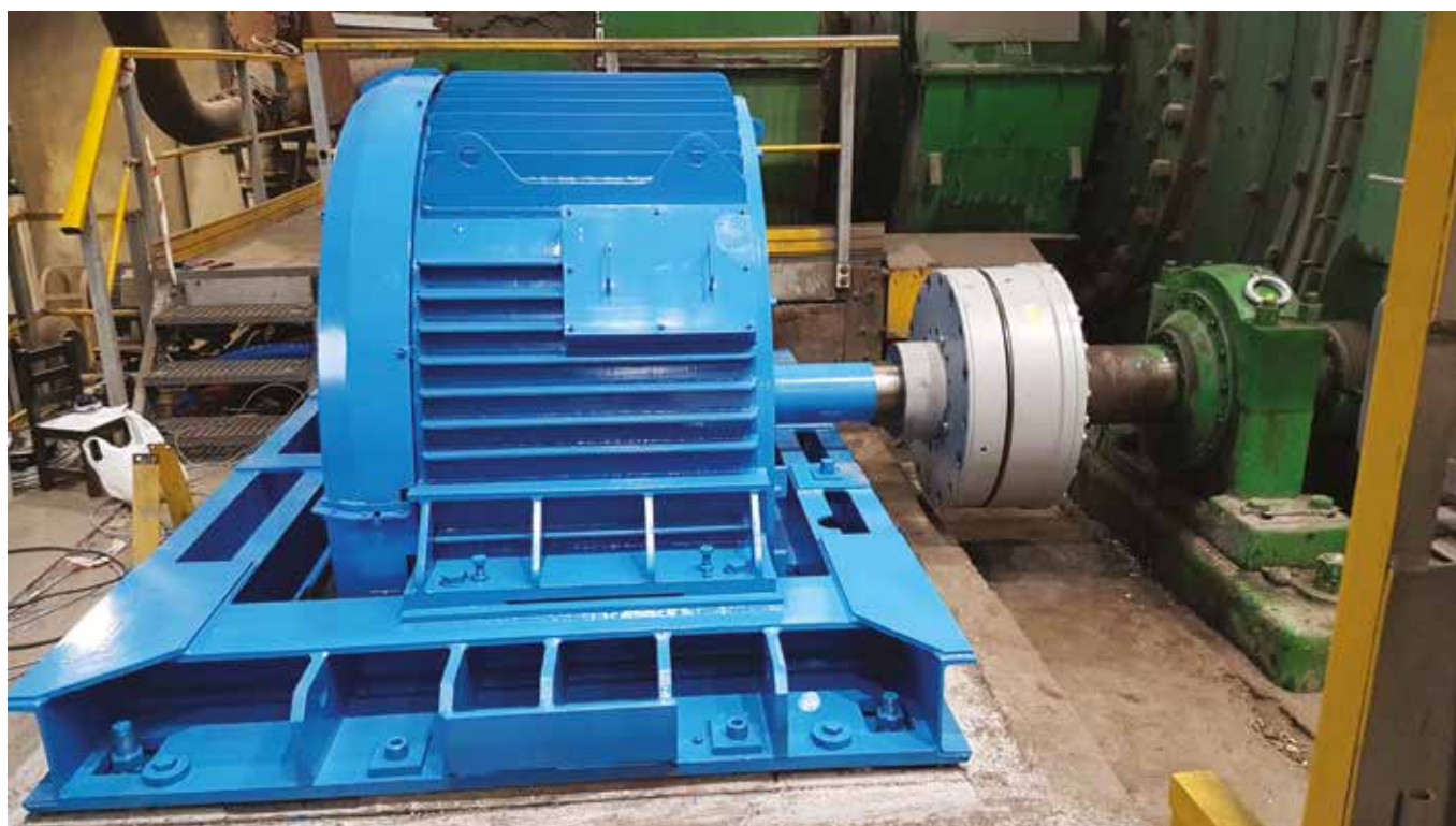
Rys. 2. Nowy energooszczędny silnik typu SMH z magnesami trwałymi o mocy 1000 kW (zdj. KGHM)
