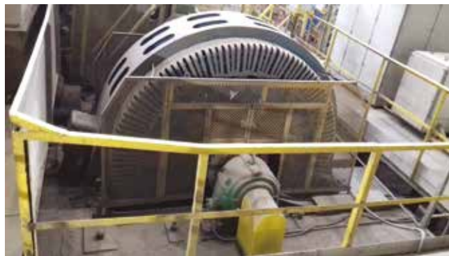
Rys. 1. Silnik energooszczędny typu SAS1832t/01 (kompleksowa wymiana na nowe, energooszczędne silniki z magnesami trwałymi została wprowadzona do planów inwestycyjnych, jako działanie priorytetowe w ramach realizacji polityki energetycznej KGHM) (zdj. KGHM)
