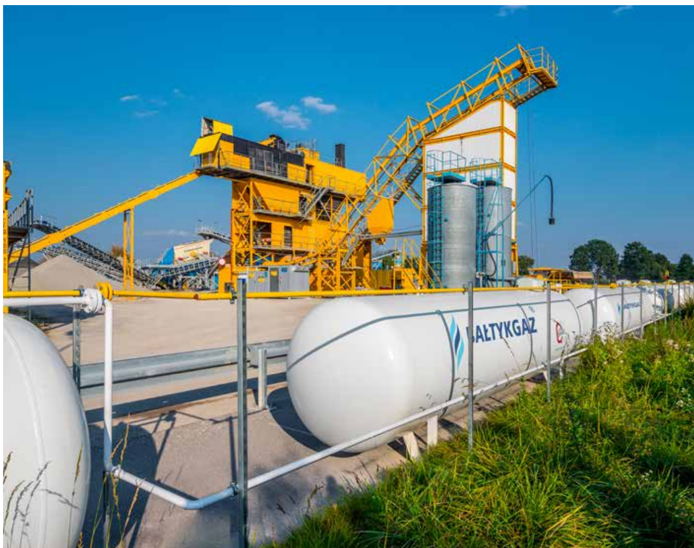
Instalacja przemysłowa (zdj. BAŁTYKGAZ Sp. z o.o.)
