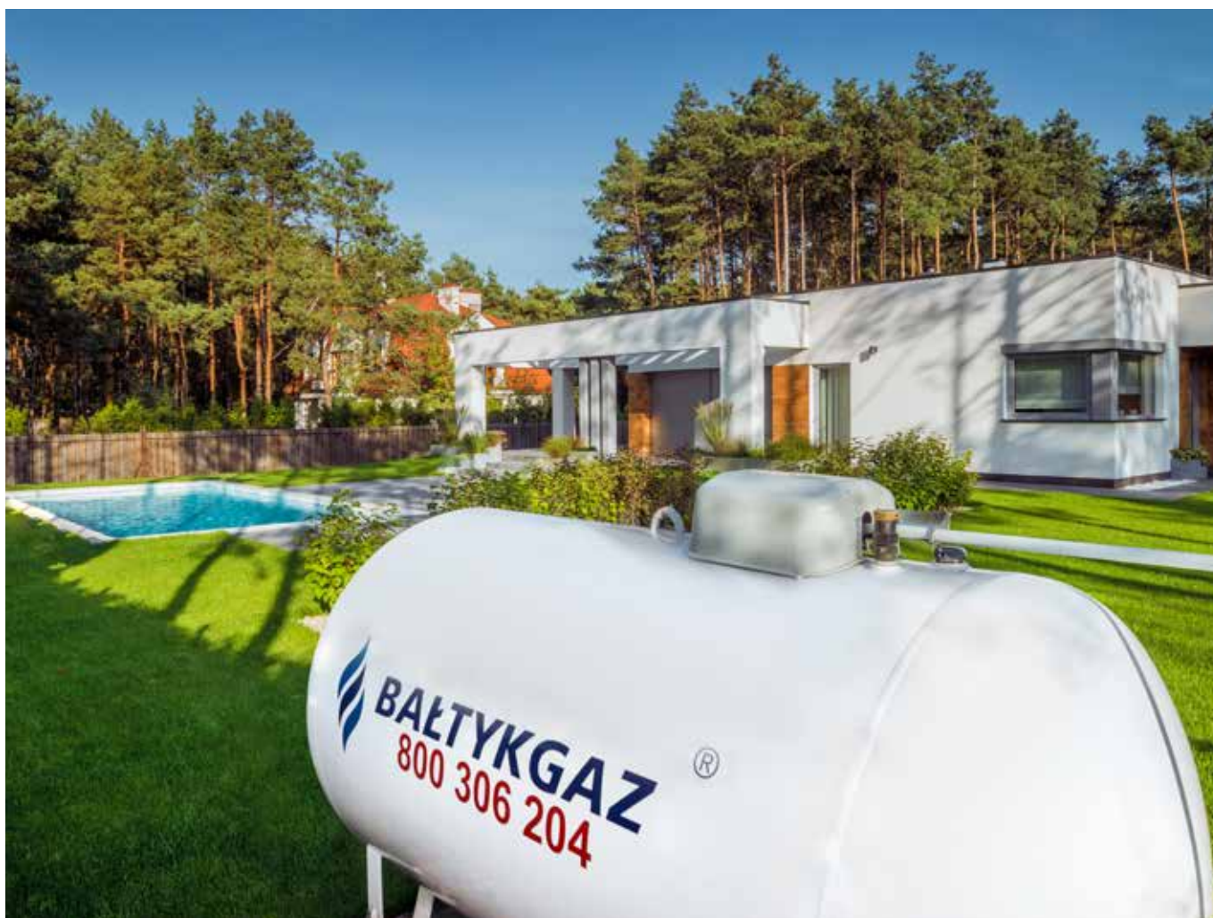
Instalacja przydomkowa (zdj. BAŁTYKGAZ Sp. z o.o.)
