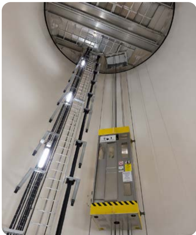
Rys. 11. Podest wiszący w morskiej turbinie wiatrowej (zdjęcie M.Klahs)
