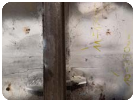
Rys.2. Pęknięcie górnego pasa dźwigara
