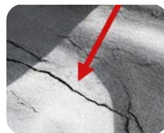
Rys. 7. Wskazanie pęknięcia konstrukcji
