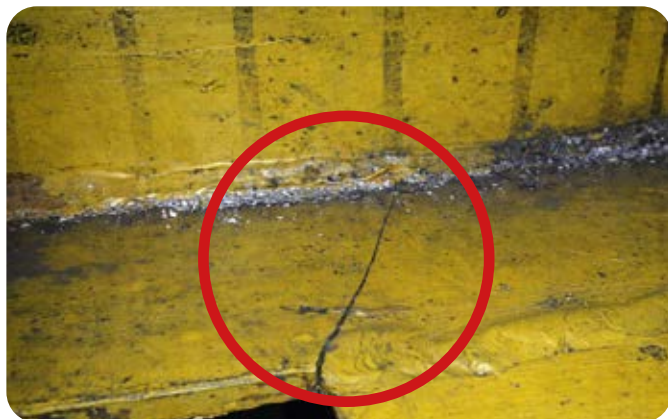
Rys. 3. Zmęczeniowe pęknięcie półki dźwigara
