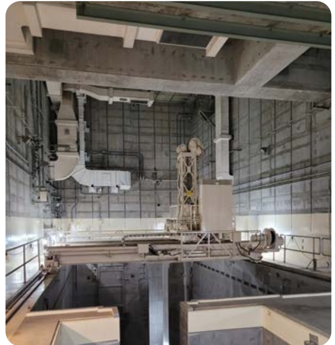
Rys. 1. Przykładowe urządzenie transportu bliskiego (UTB), stanowiące wyposażenie transportowo-technologiczne do przemieszczania i składowania paliwa jądrowego (wg § 2. 1 pkt. 13 [2])
