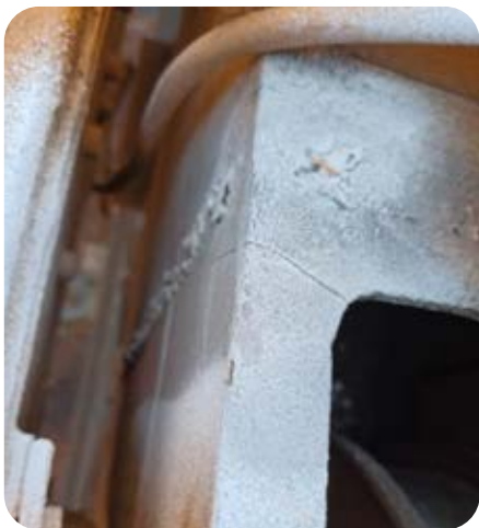
Rys.3. Pęknięcie konstrukcji czołownicy
