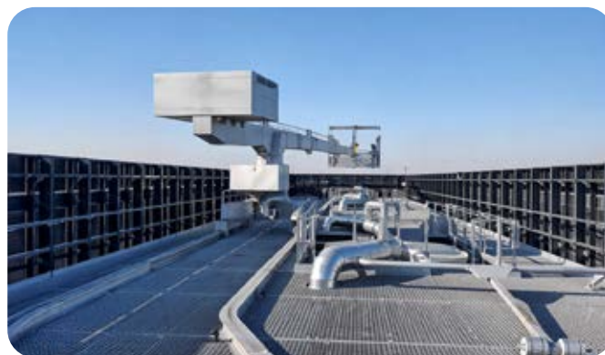
Rys. 9. Podest BMU zamontowany na torowisku (fot. M. Klahs)
