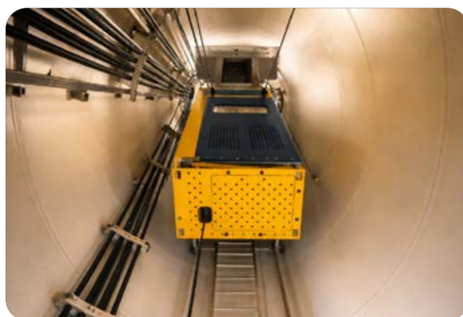
Rys. 2. Dźwig do transportu osób lub ładunków w turbinie wiatrowej
