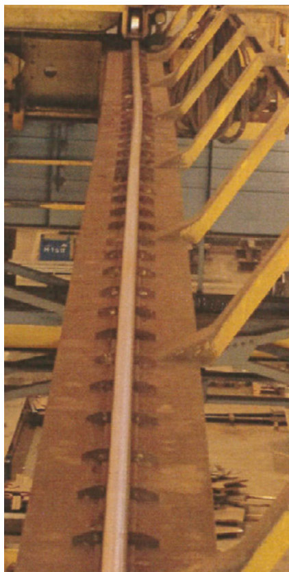
Rysunek 4. Deformacja dźwigara suwnicy
