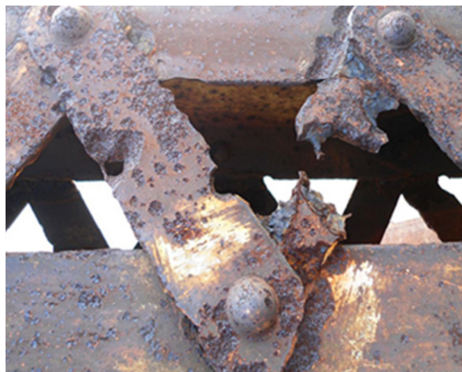
Rysunek 2. Ubytki korozyjne konstrukcji
