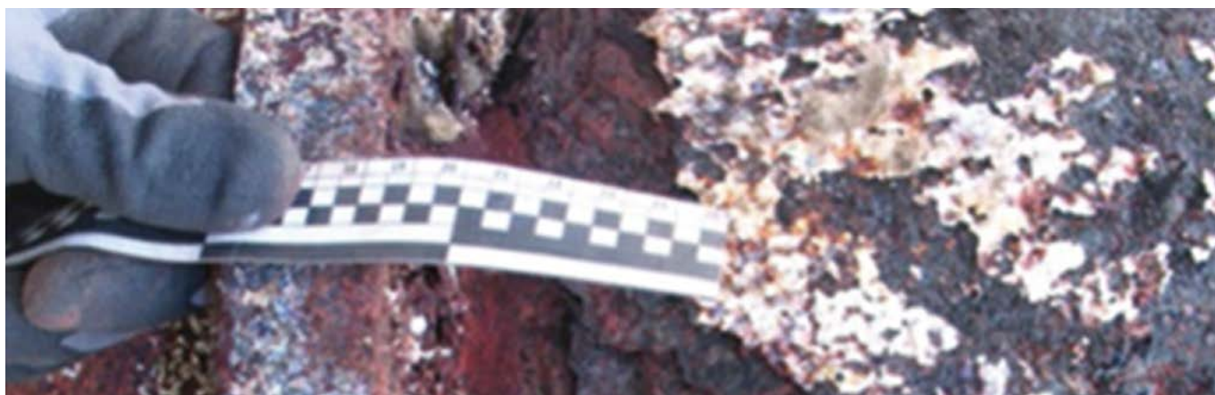
Zdj. 2. Przykład korozji pod izolacją zbiornika ciśnieniowego ze stali węglowej.
