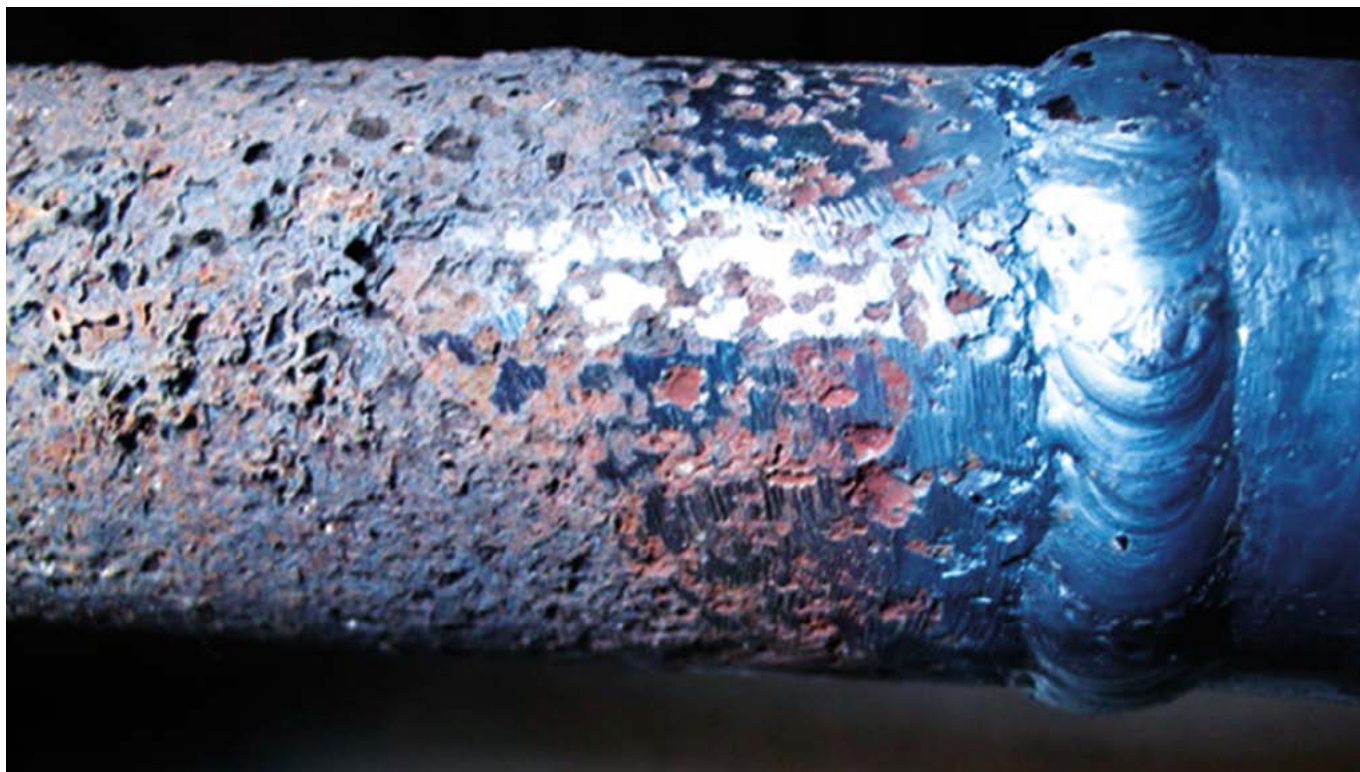
Zdj. 1. Przykład korozji pod izolacją stali węglowych i niskostopowych.
