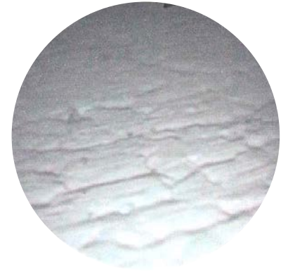
Pęknięcia w materiale płaszcza
