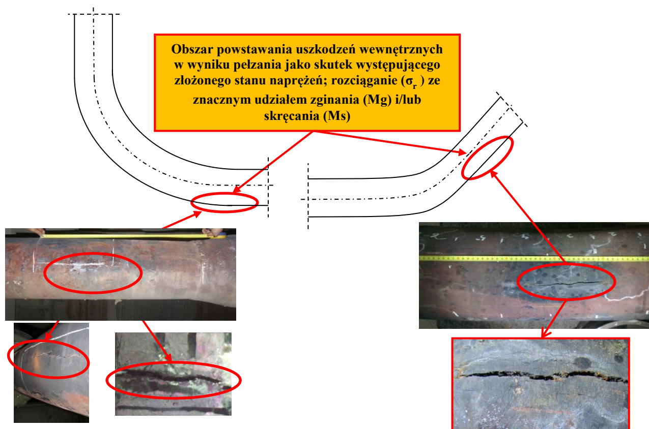
Rys. 9. Przykłady uszkodzeń łuków rurociągów parowych pracujących w warunkach pełzania jako skutek występującego złożonego stanu naprężeń spowodowanego zbyt małą liczbą stopni swobody.
