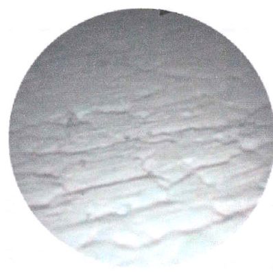
Pęknięcia w materiale płaszcza komory
