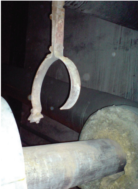
Zerwana obejma na rurociągu
