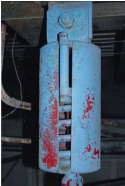
Niezdjęta blokada na zawieszeniu jednosprężynowym
