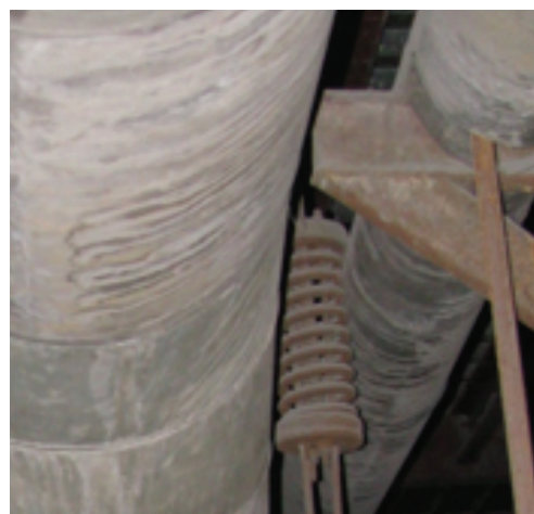
Źle zbudowane zawieszenie sprężyste
