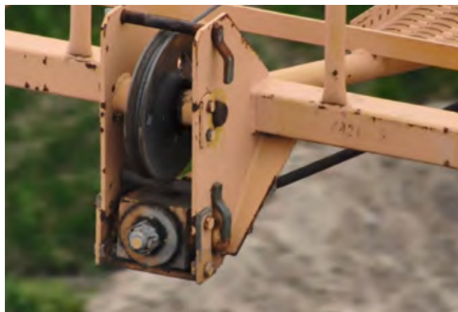
Fot 1. Widok zakończenia wyciągu
