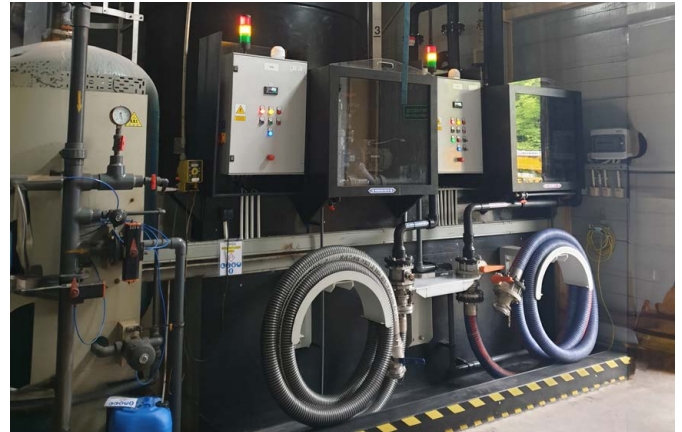
Rys. 6. Widok na instalację wewnątrz budynku: podlegający dozorowi technicznemu zbiornik magazynowy ługu sodowego NaOH oraz stacje rozładunkowe dla zbiornika NaOH i zbiornika na HCl znajdującego się na zewnątrz obiektu (zdj. AMARGO®)
