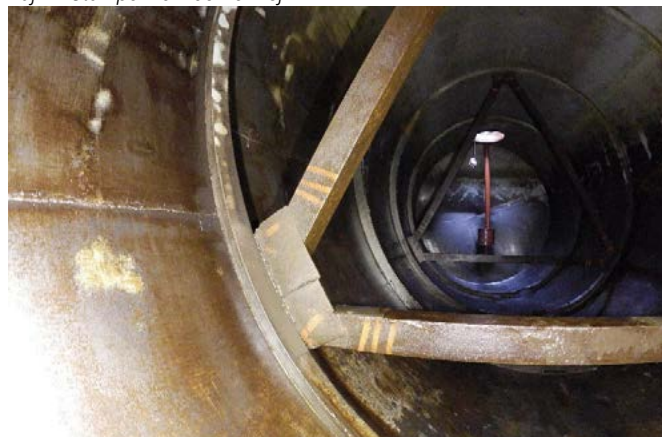
Zdj. 8. Stan powłoki ochronnej
