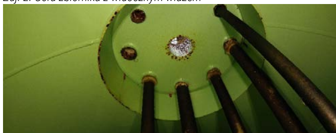
Zdj. 3. Rury pomiarowe oraz technologiczne
