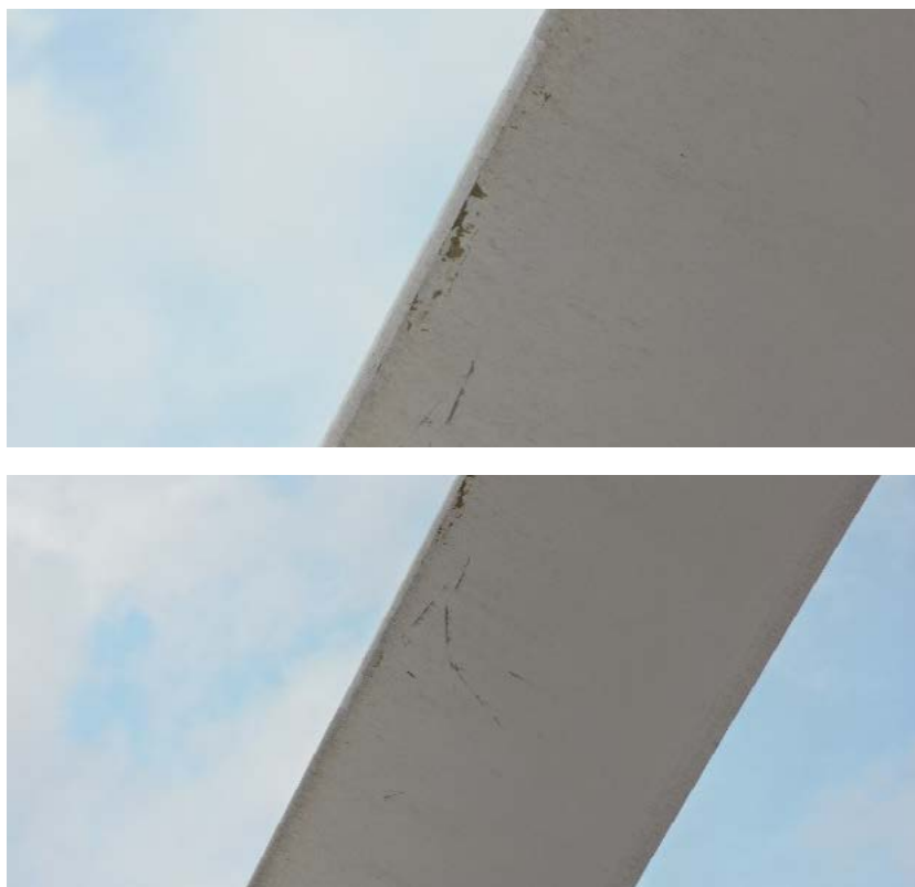
Rys. 3. Ubytki farby na krawędzi natarcia
