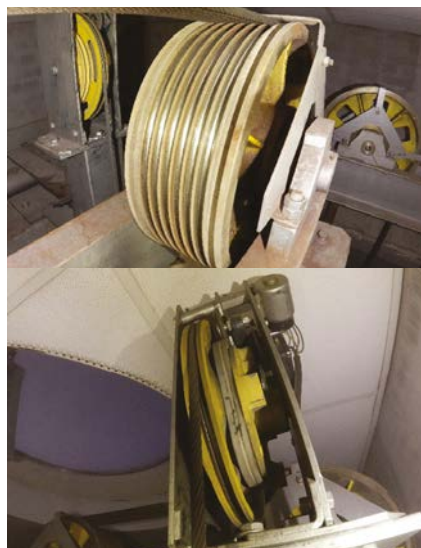
Zdj. 9. Obraz z drona przedstawiający uszkodzenie koła linowego w dźwigu osobowym
