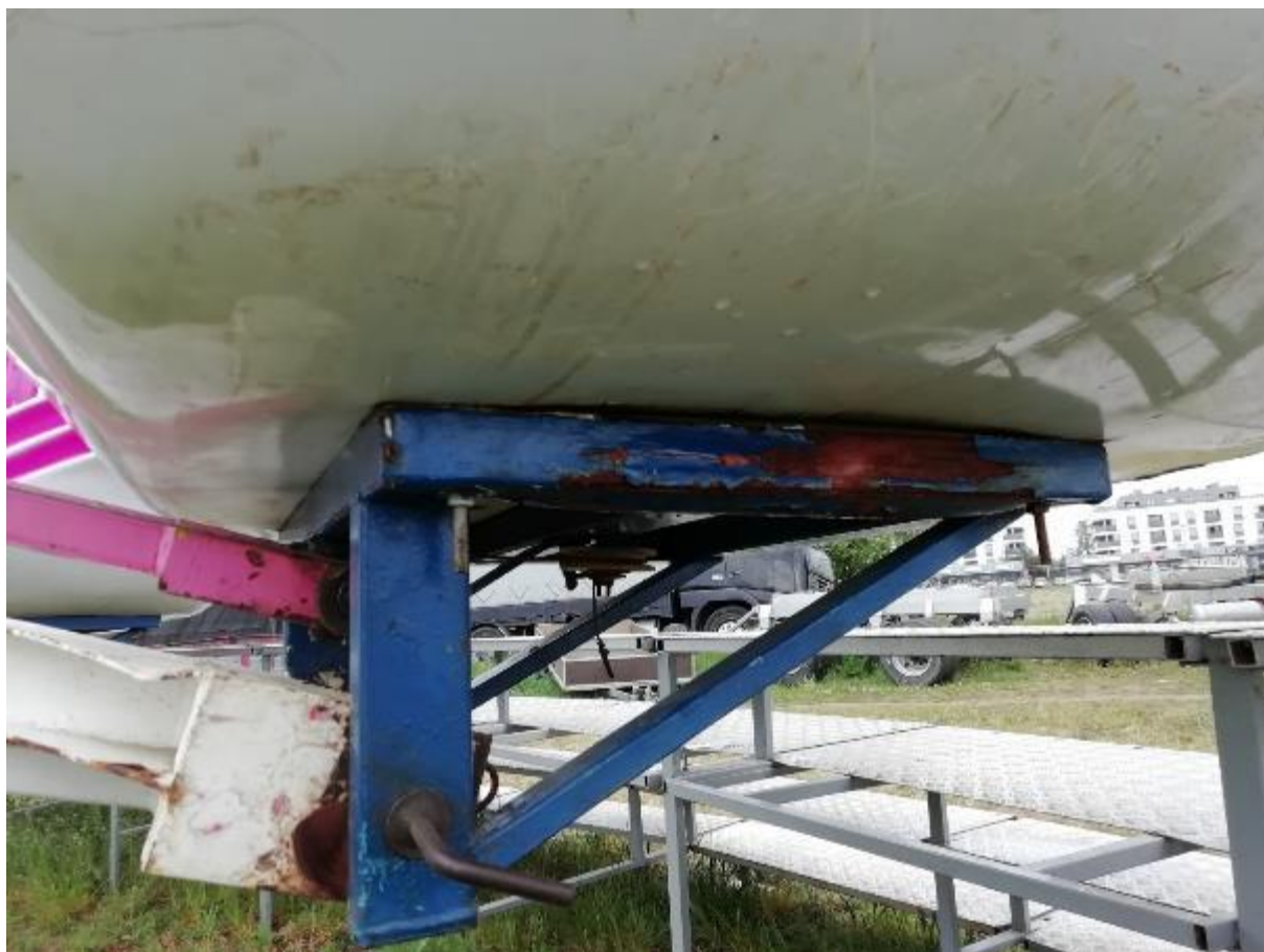
Zdjęcie 40. Deformacja elementów kratownicy.
