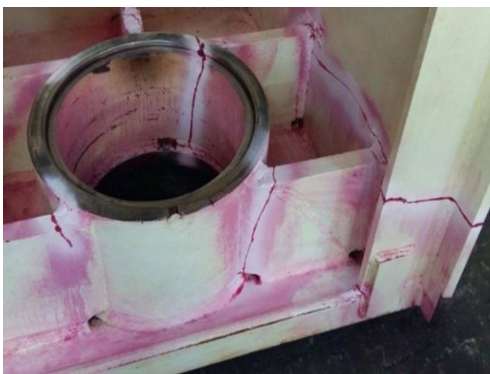
Zdjęcie 31. Pęknięcia konstrukcji.
