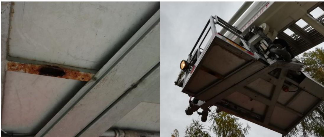
Rysunek 50. Korozyjne zniszczenie ramy nośnej kosza podestu przejezdnego.
