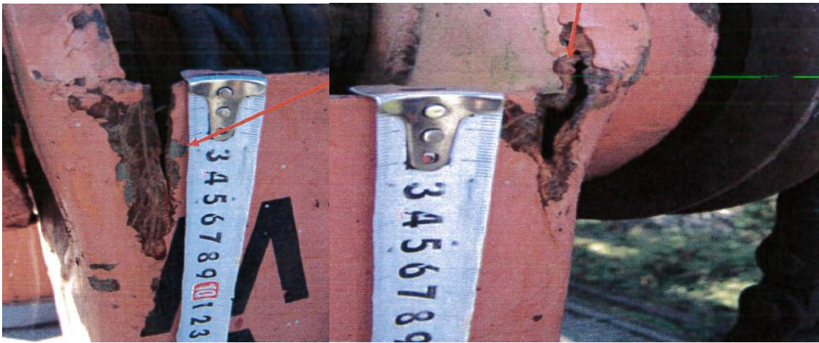
Rysunek 54. Korozja i pęknięcia konstrukcji nośnej kolumny podestu przejezdnego.
