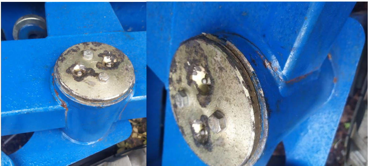
Rysunek 46. Pęknięcia wokół tulei połączenia sworzniowego podestu przejezdnego.
