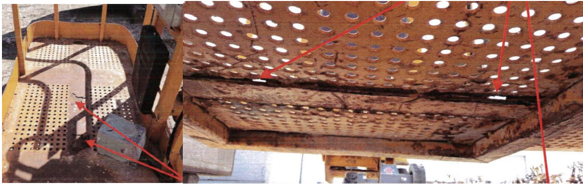
Rysunek 52. Korozja poszycia oraz ramy kosza podestu ruchomego przejezdnego.
