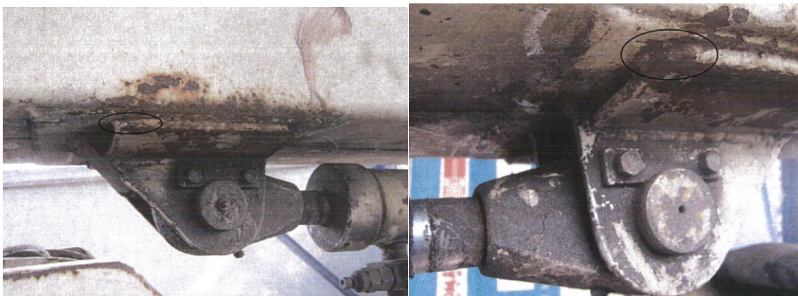
Rysunek 53. Pęknięcia wysięgnika podestu przejezdnego w miejscu mocowania silownika.
