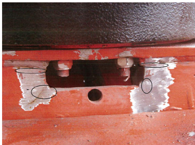
Rysunek 57. Pęknięcia zmęczeniowe ramy – porównanie widoczności pęknięcia bez i z usuwaniem powłoki malarskiej.
