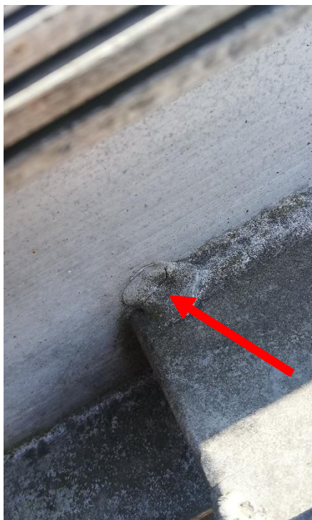
Rysunek 26. Pęknięcie spoiny konstrukcji nośnej wyciągu towarowego.
