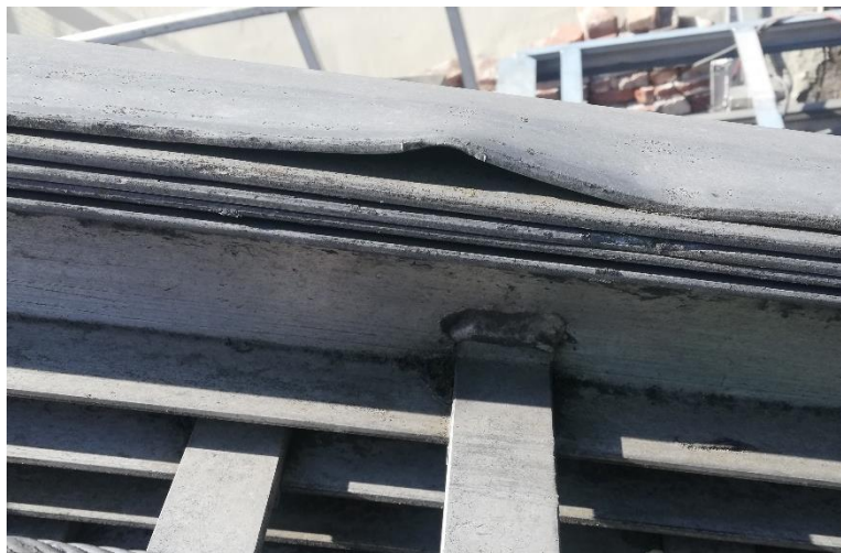
Rysunek 25. Odkształcenie konstrukcji nośnej wyciągu towarowego.
