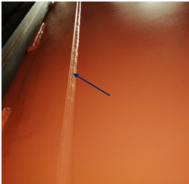
Rysunek 32. Przykładowe spoiny kolumny układnicy podlegające badaniom.
