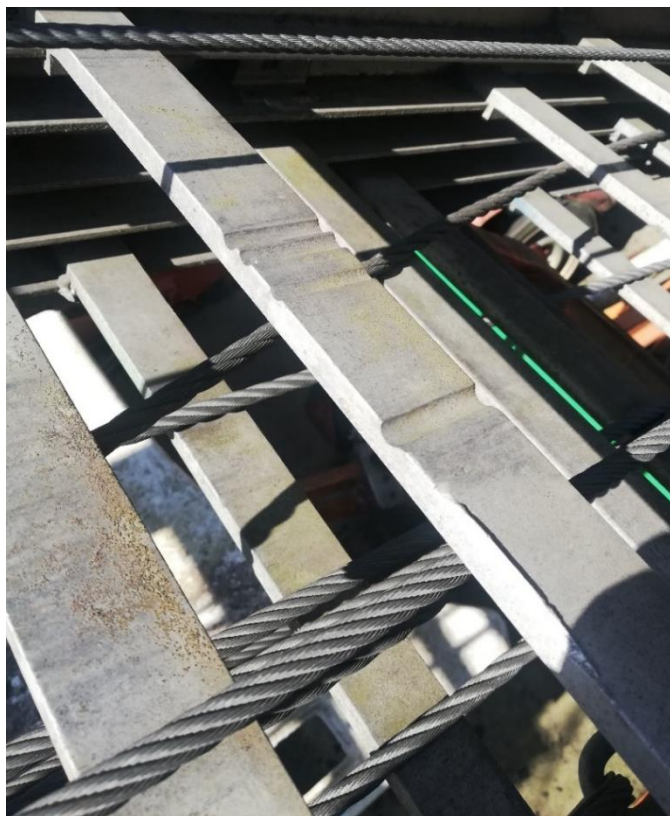
Rysunek 7. Wytarcie poprzeczek konstrukcji nośnej wyciągu towarowego.
