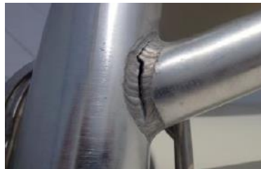
Zdjęcie 13. Nieciągłości stwierdzone podczas badań wizualnych masztów dźwigów budowlanych.
