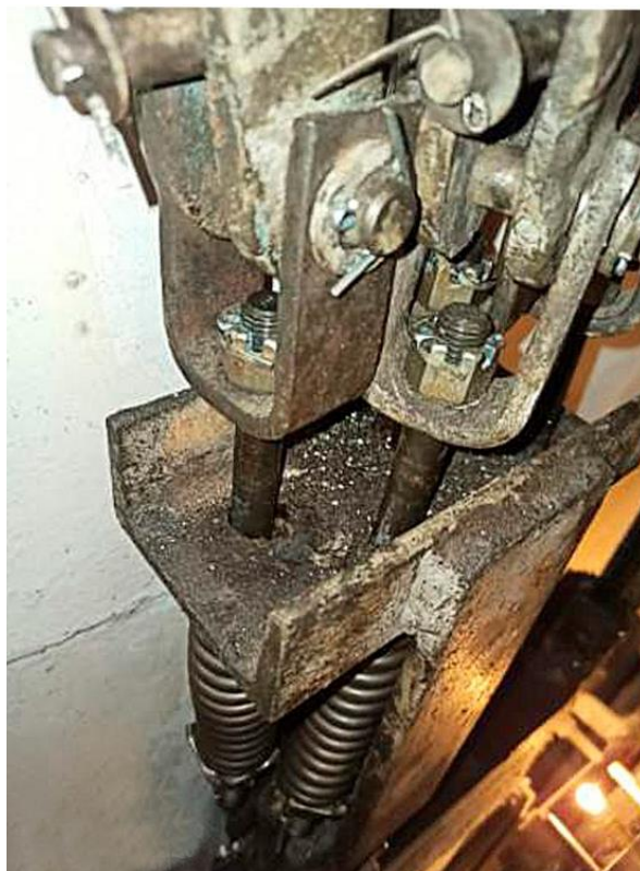
Zdjęcie 12. Przykład połączenia sworzniowego na linach nośnych zawieszenia kabiny lub przeciwwagi.
