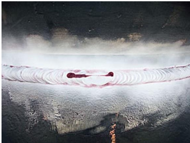
Zdjęcie 17. Przykład nieciągłości stwierdzonej metodą penetracyjną.
