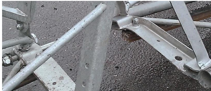
Zdjęcie 29. Maszt dźwigu budowlanego po utracie stateczności.
