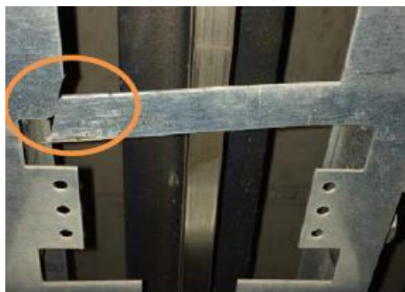
Zdjęcie 27. Pękanie bocznej części ramy kabinowej.
