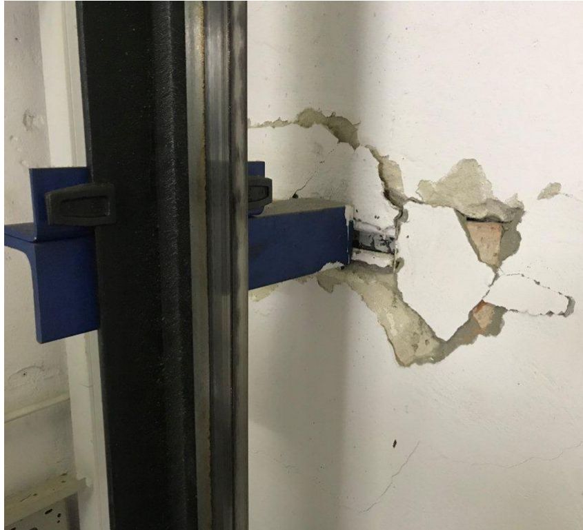
Zdjęcie 30. Wyrwane korytko kotwy zawieszenia kabiny.
