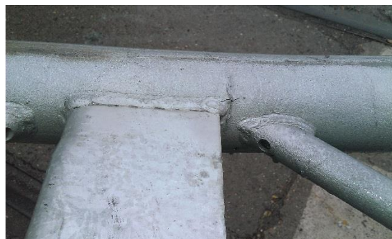
Zdjęcie 14. Nieciągłości stwierdzone podczas badań wizualnych masztów dźwigów budowlanych.
