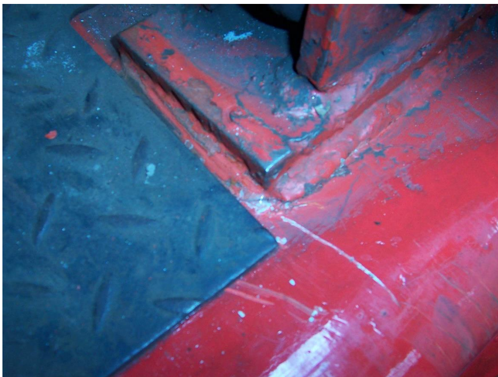
Rysunek 32. Pęknięcie ramy wózka jezdniowego podnośnikowego z mechanicznym napędem podnoszenia.
