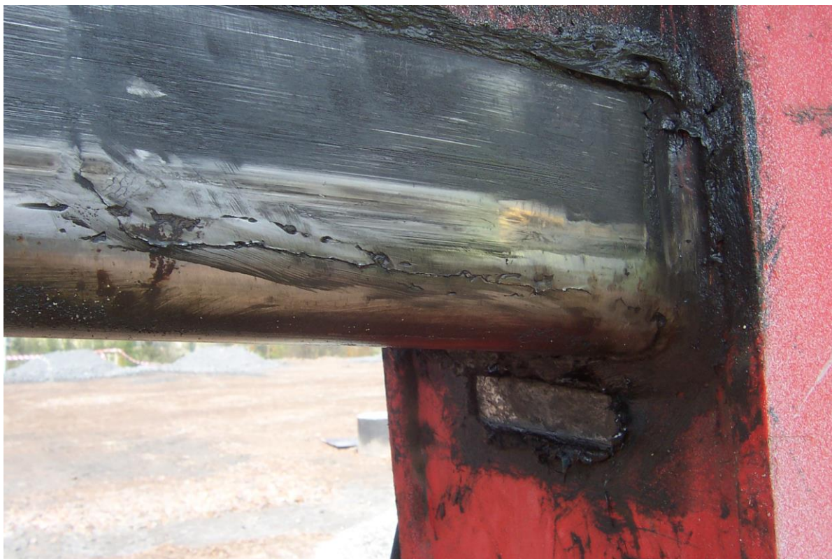
Rysunek 52. Pęknięcie wysięgnika wózka jezdniowego podnośnikowego z mechanicznym napędem podnoszenia specjalizowanego ze zmiennym zasięgiem.
