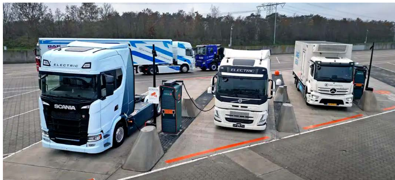
Rys. 7.12 Zabezpieczenie mechaniczne stacji ładowania eHDV w postaci zapór betonowych; źródło: www.milence.com
