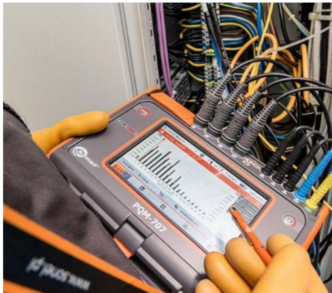
Rys. 7.8 Monitoring parametrów jakościowych w stacji ładowania pojazdów eHDV za pomocą analizatora jakości energii
